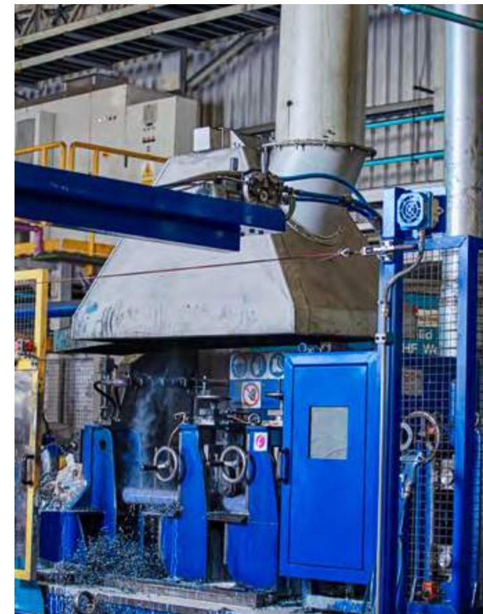
Campana extractora de humos, su función es captar los humos de producto de la soldadura de planta de tubos y los extrae con el objetivo de purificarlos y en tal sentido mitigar el impacto ambiental.
