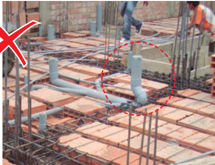
Tubería en un lugar inadecuado. Observe tubo 4" dentro de viga
