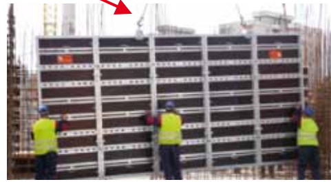
Cable de grúa Figura 1
