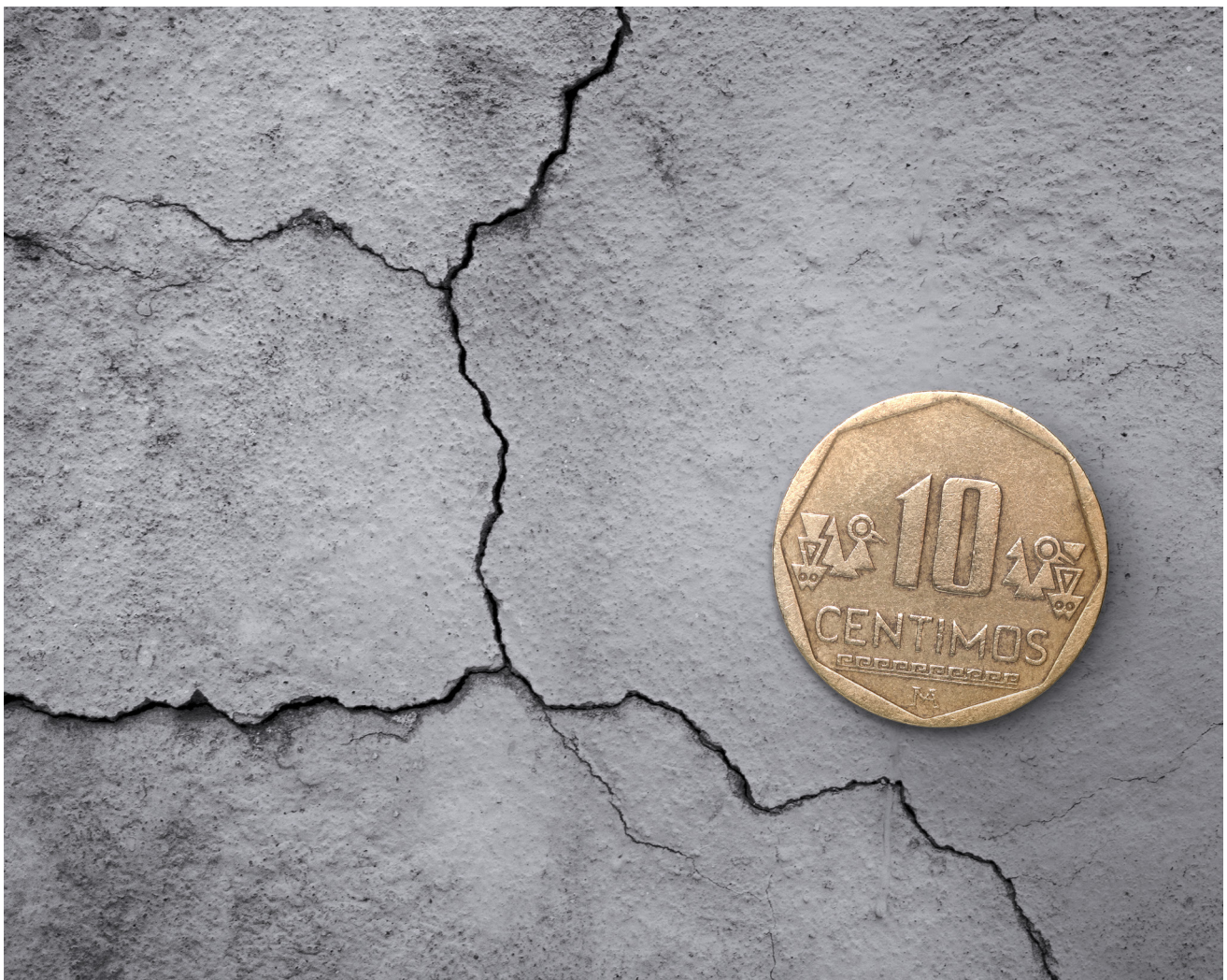
AGRIETAMIENTO DEL CONCRETO
